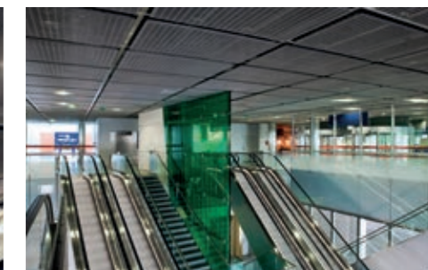
Funktionale Deckenverkleidung. Terminal S3, Flughafen Roissy Charles de Gaulle, Paris, Frankreich.
